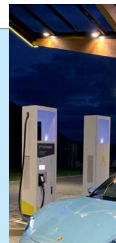
Sympathisch: Beleuchtung und Wetterschutz sprechen für die Fastned-Stationen.
